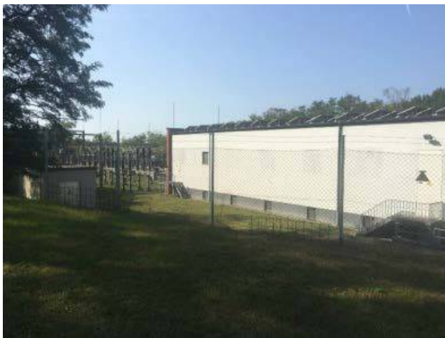
Abbildung 86: Umspannanlage in Aschaffenburg. Eigene Aufnahme GreenAdapt 2020.
