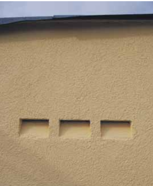
Fledermauskasten in Fassade integriert © Sylvia Weber
