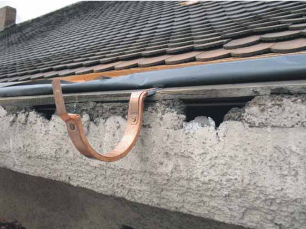
Ausbruch in Dachtraufe © S. Weber, LBV München
