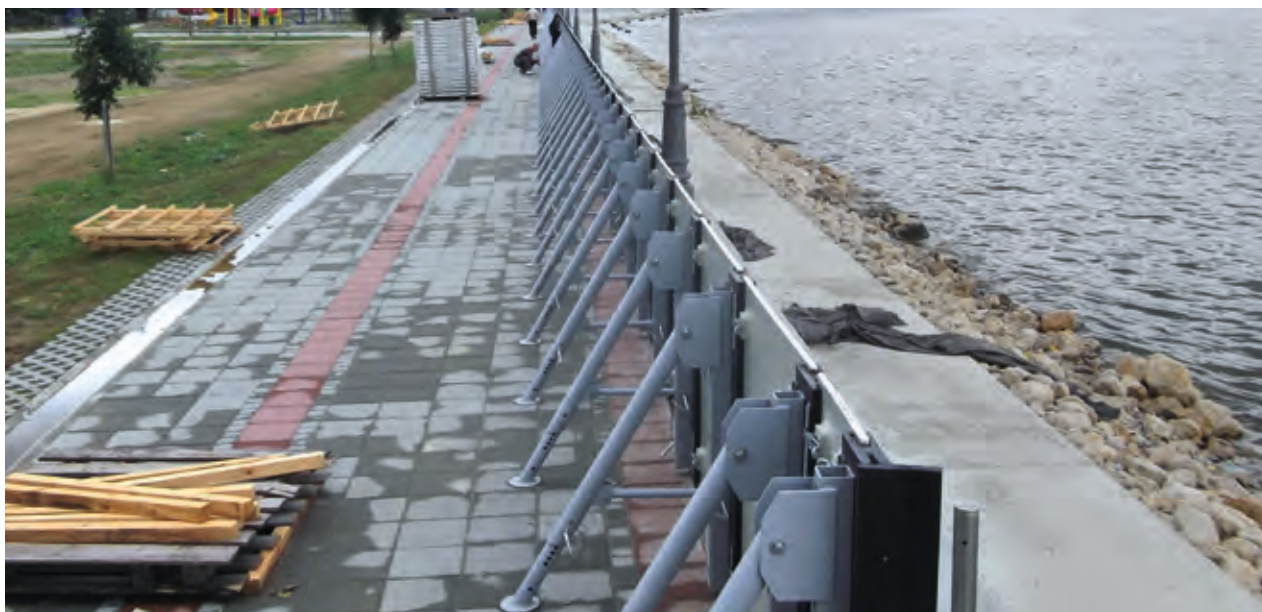
Hochwasserschutz mit Hochwasserschutzplatten aus Kunststoff
