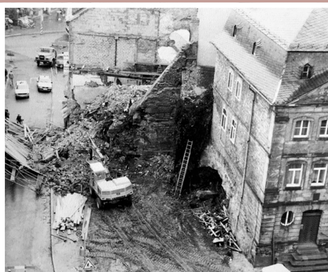
Oben: Wermbachstraße/Dalbergstraße. Links: Abbruch in der Dalbergstraße, Gerüsteinsturz, 1980er-Jahre. Unten: Ensemble am Stiftsplatz.
